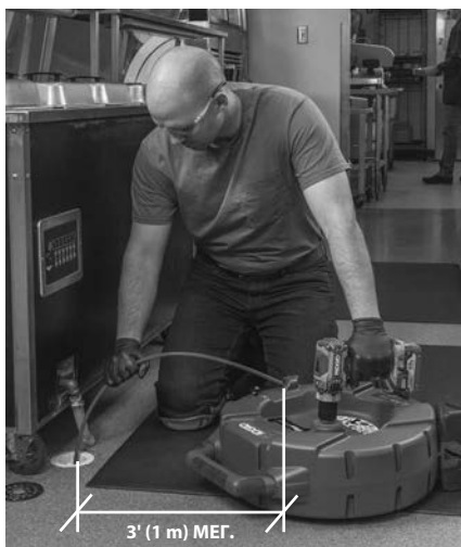
Εικόνα 11 – Σε θέση λειτουργίας
