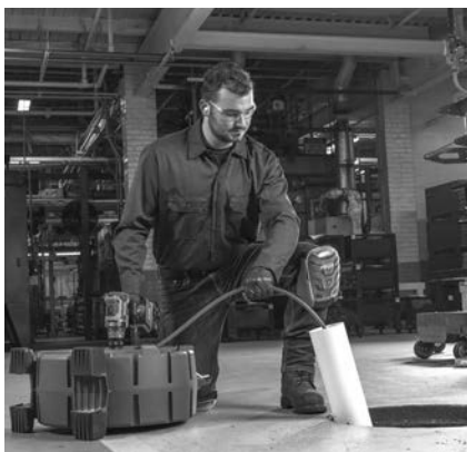
Figura 5 – Exemplo no qual se estende o acesso à canalização a até 3' da saída do cabo da máquina
