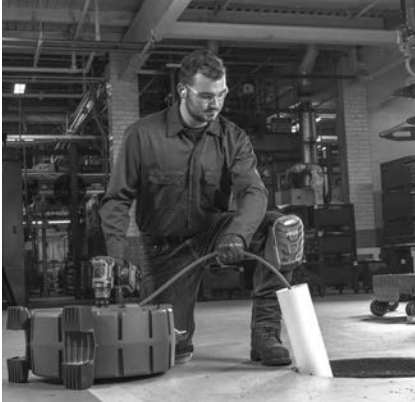
Şekil 5 – Makinenin Kablo Çıkışının 3' İçerisine Kanalı Erişimine Doğru Uzatılmasının Örneği
