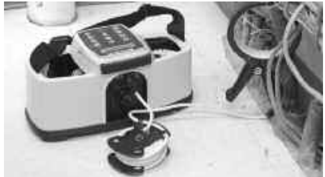
Figura 12 – Pinza induttiva collegata ad un conduttore
