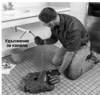
Фигура 5 – Пример за удължен достъп до канала до 3' от изхода за кабел на машината
