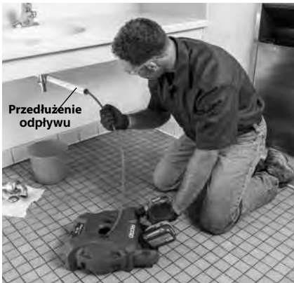
Rysunek 5 – Przykład przedłużenia wylotu odpływu na odległość mniejszą od 3' od wyprowadzenia wałka giętkiego z maszyny
