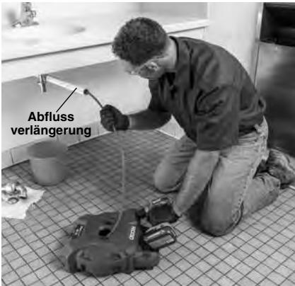
Abbildung 5 – Beispiel der Verlängerung der Abflussöffnung auf einen Abstand von maximal 3' zum Spiralaustritt der Maschine
