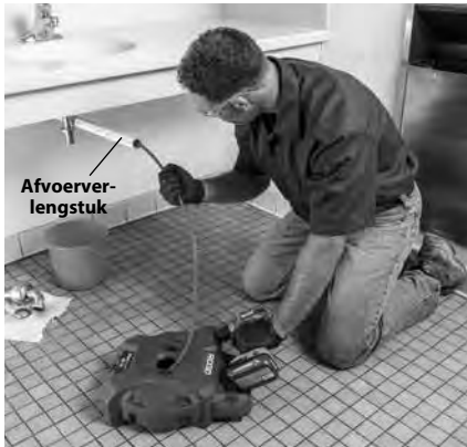
Figuur 5 – Voorbeeld van een verlenging van de afvoeropening tot minder dan 3' van de veeruitvoer van de machine
