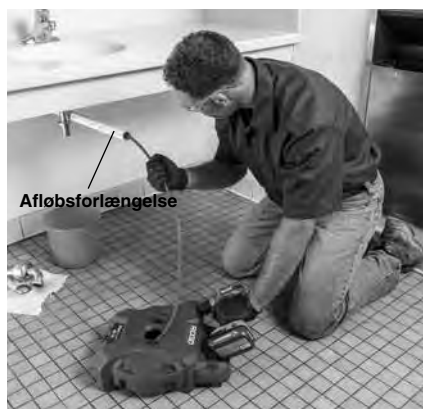
Figur 5 – Eksempel på forlængelse af afløbsadgang til inden for en afstand af 3' fra maskinens spiraludgang
