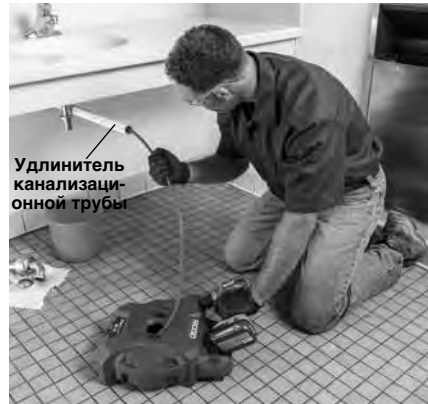
Рис. 5 – Пример удлинения доступа к канализационной трубе до расстояния 3' от отверстия выхода троса
