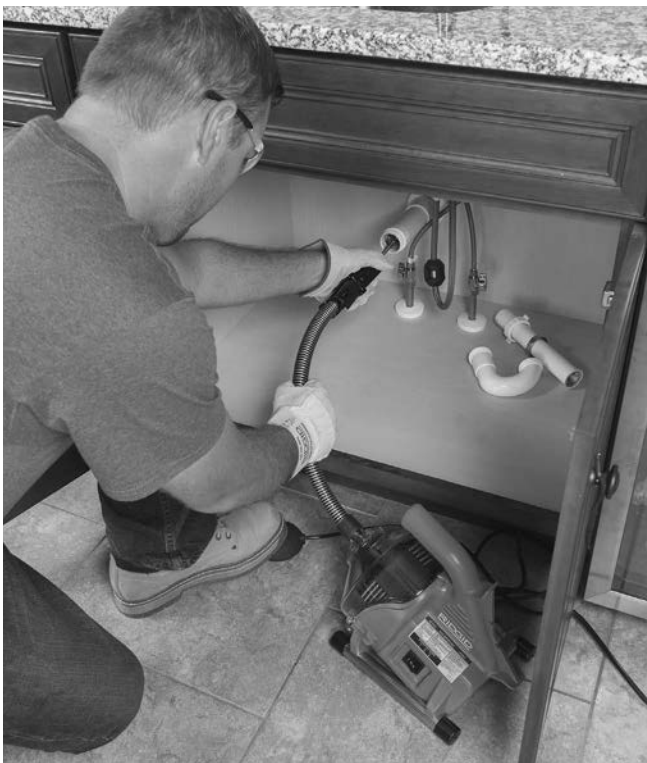
Εικόνα 8 – Σε θέση λειτουργίας
