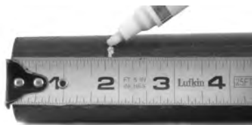
Figure 6A – Repérage de la profondeur d'insertion du tuyau à l'aide d'un mètre à ruban
