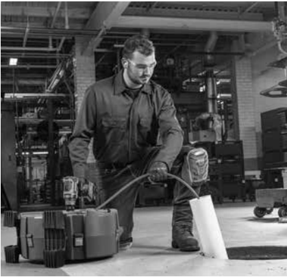
Abbildung 5 – Beispiel der Verlängerung der Abflussöffnung auf einen Abstand von maximal 3' zum Spiralenaustritt der Maschine
