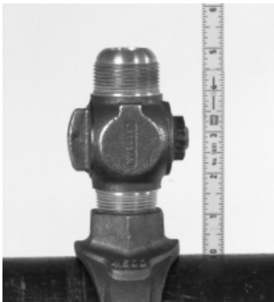
Figure 8 – Relevé du décalage de la vanne.
