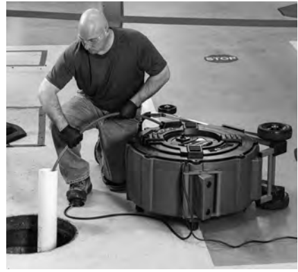
図5 - 機械のケーブル引出口から管内への入り口までの距離が1m以内になるようにパイプを使用して延長している例
